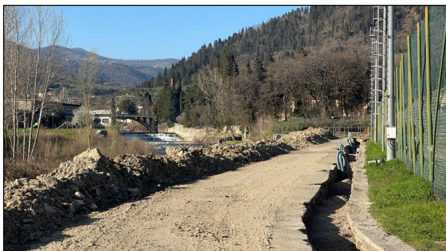
Figura 4 - Loc. La Briglia – Vaiano – ripristino condotta fognaria divelta dal fiume Bisenzio; In ordine orario si riporta lo stato dei luoghi e il completamento del ripristino della continuità idraulica dell'infrastruttura fognaria
